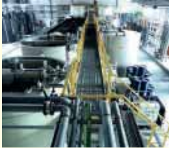
Zentrale Abwasseranlage zur Reinigung von schadstoffbeladenen Abwässern aus der Oberflächenbehandlung bei einem Aluminiumverarbeiter.
